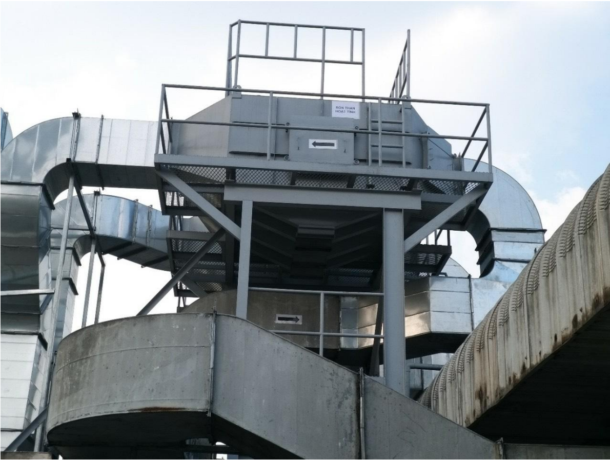
Hệ thống xử lý khí thải từ quá trình sơn 02
