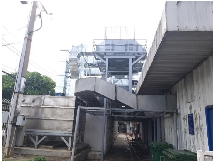
Hệ thống xử lý khí thải từ quá trình sơn 01
